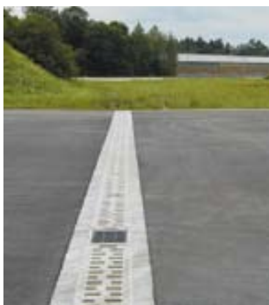
ACO DRAIN® Monoblock RD 300 ze skrzynką odpływową na lotnisku w Marching
