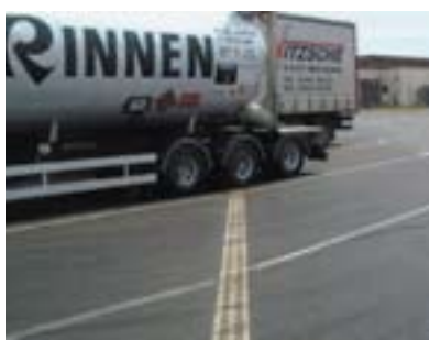
ACO DRAIN® Monoblock RD 200 V, autostrada A1 (Niemcy), jako odwodnienie poprzeczne parkingu
