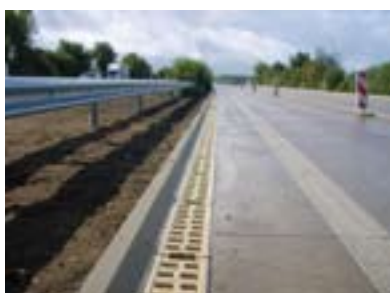
ACO DRAIN® Monoblock RD 200 V na autostradzie A1, jako odwodnienie podłużne
