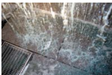
Maksymalne zalewanie obszaru wyraźnie wskazuje na ważną rolę osłony wpustu dachowego dla odwodnienia dachu
