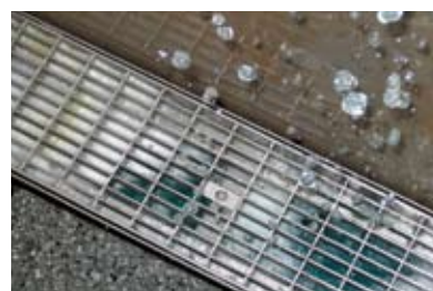
Poziom wody do dolnej krawędzi przykrywającego rusztu
