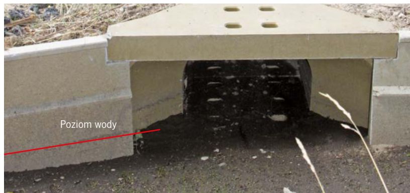
Płyty denne z drenażem po silnym opadzie deszczu
